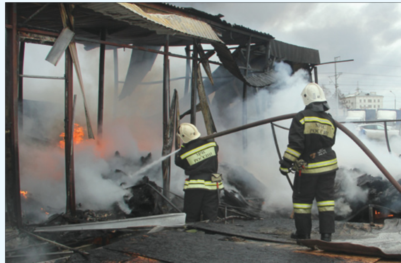
Не выдержав высокой температуры, разрушились металлоконструкции
